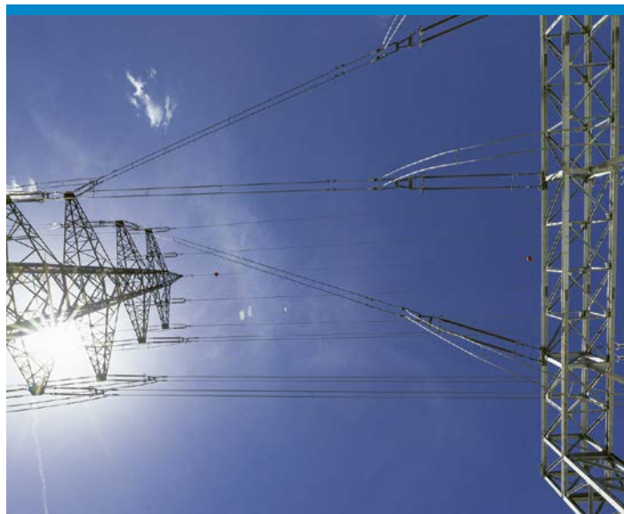
Le raccordement de la ligne de Nant de Drance à la ligne THT Chamoson – Romanel, Le Verney, mai 2022
